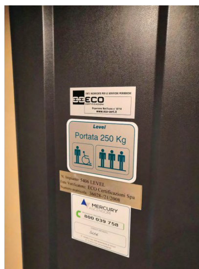
Vista ascensore interno
