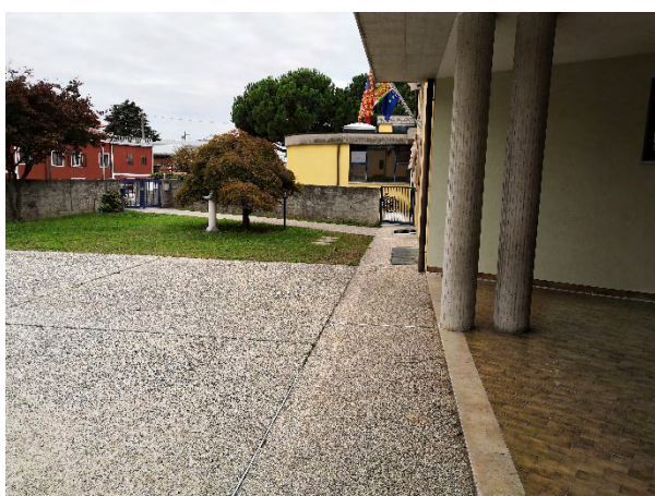
vista del porticato di accesso. La soglia in marmo esterna presenta uno scalino di 3,7 cm
